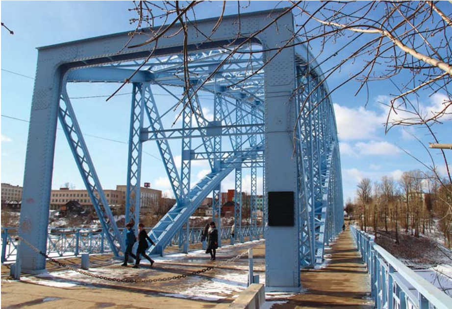
г. Боровичи, мост Белелюбского, первый арочный мост в России, построенный в 1905 г.
